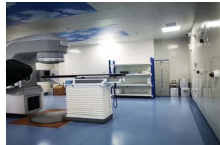
2#加速器治疗室东侧 3#加速器治疗室
