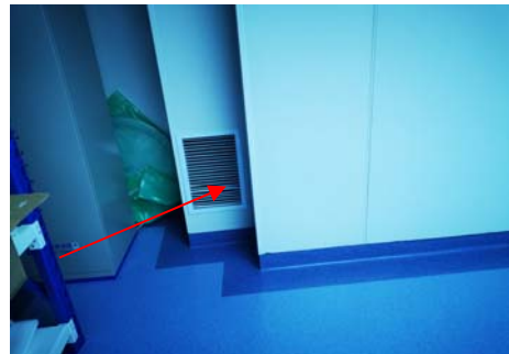
2#加速器机房排风系统
